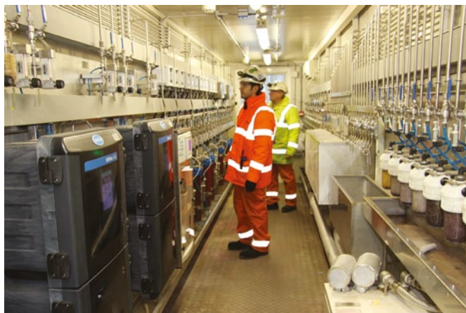
Camera di analisi della caldaia
